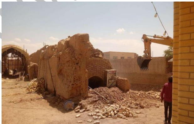
(تخریب ساختمان‌های خشتی)
